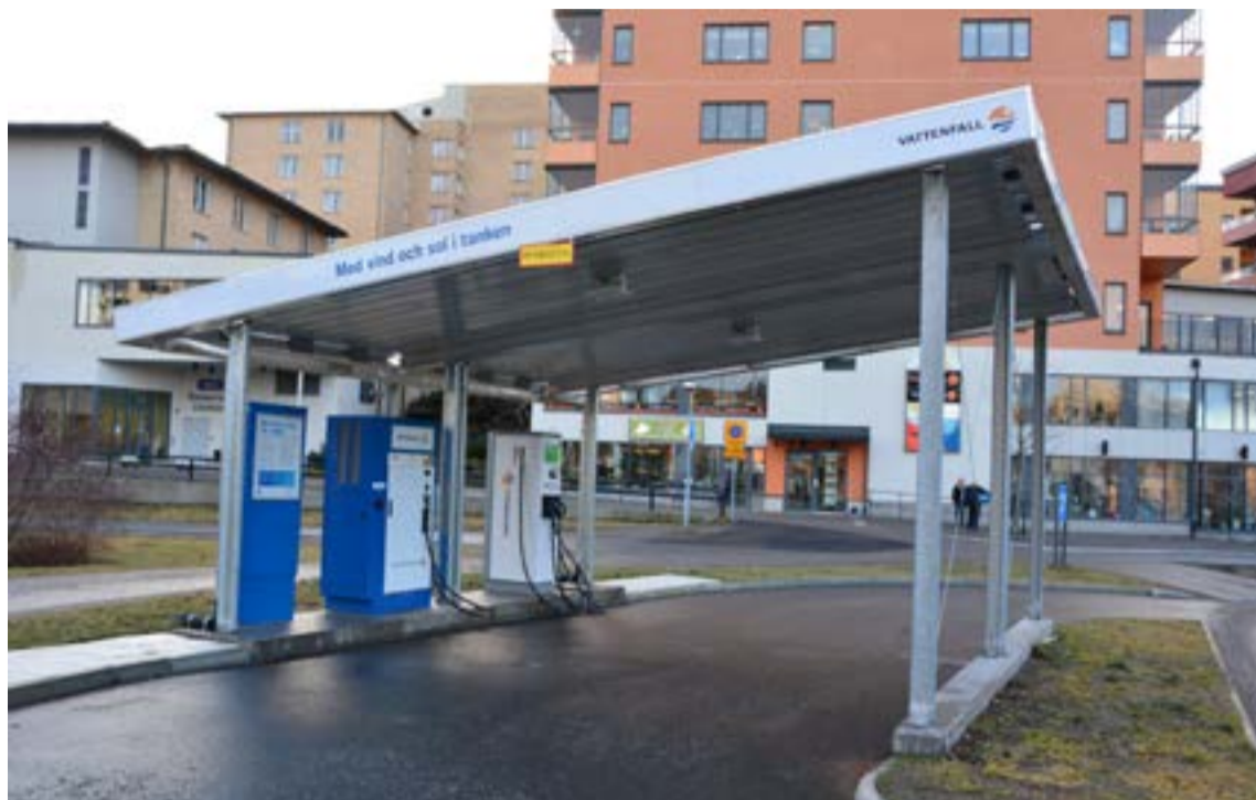
Laddstationen är lättare att hitta i verkligheten än på nätet.
